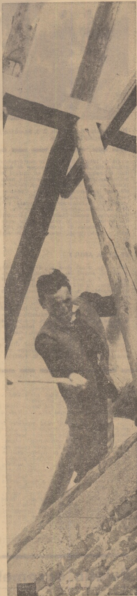
La cooperativa agricolă din comuna Milcov, județul Vrancea, se construiește un nou adăpost pentru o sută de vaci cu lapte
