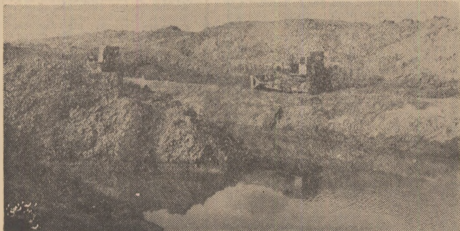
Noile stații ce vor pompa apa din Dunăre și Borcea vor asigura irigarea a 130 000 ha de teren agricol în Cimpia Dunării și a Bărăganului. În fotografie: lucrări de amenajare a terenului în zona amintită
