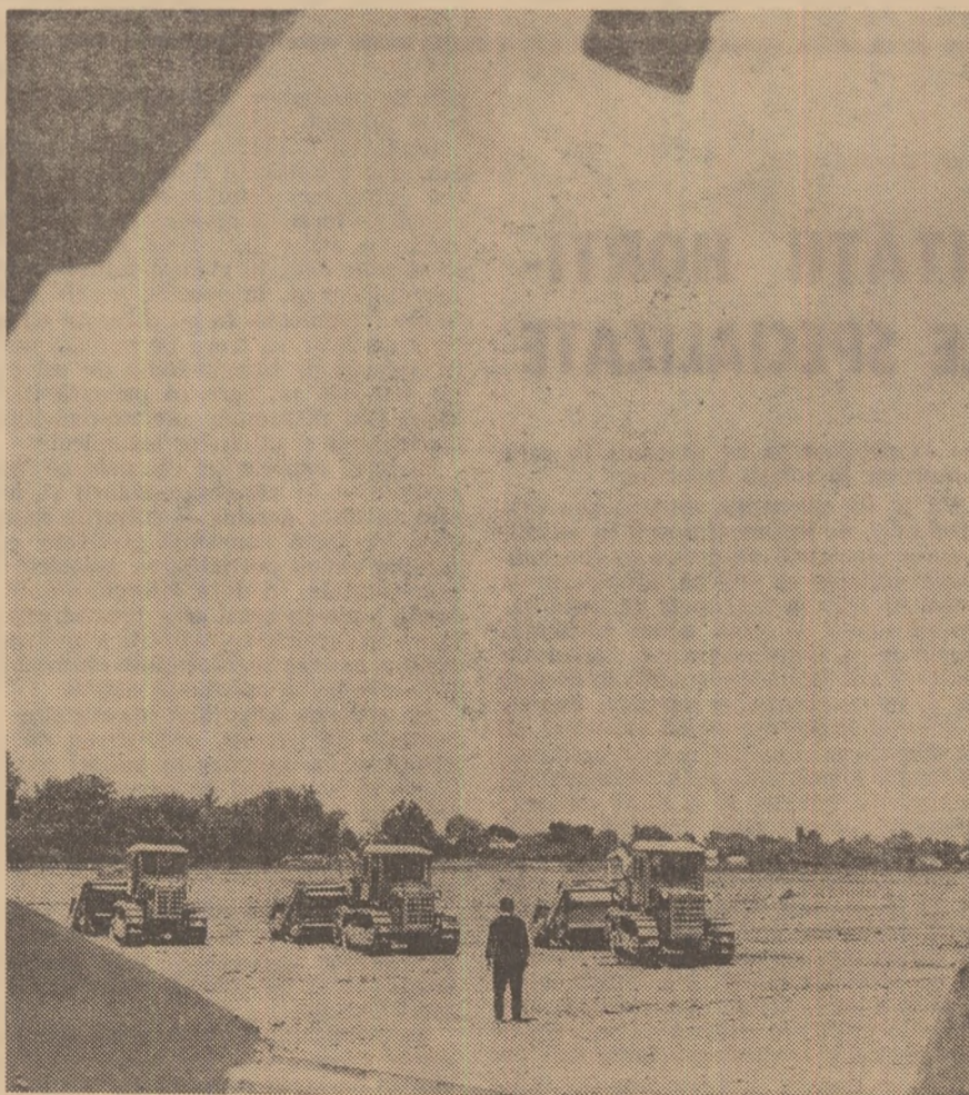
Mecanizarea lucrărilor cunoaște o permanentă dezvoltare și în sectorul îmbunătățirilor funciare. În fotografie: aspect de pe șantierul „30 Decembrie”, din preajma Capitalei
