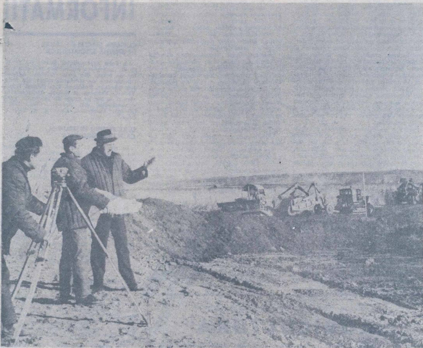
O imagine tot mai des întâlnită pe cuprinsul țării : oameni și mașini iau cu asalt noi terenuri, ridicându-le rodnicia. În fotografie : aspect de pe unul din șantierele de îndigui și desecări de pe Valea Ierului, județul Bihor
