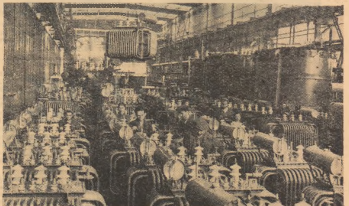
Uzinele „Electroputere” Craiova. Un nou grup de transformatori care va fi în curînd gata pentru a fi expediat.
