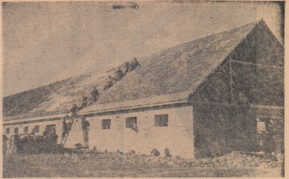
Colectiviztii din comuna Vulc an, regiunea Brașov, construiesc peste plan, în acest an, un grajd pentru vite cu o capacitate de 120 capete. Iată un aspect al șantierului.
