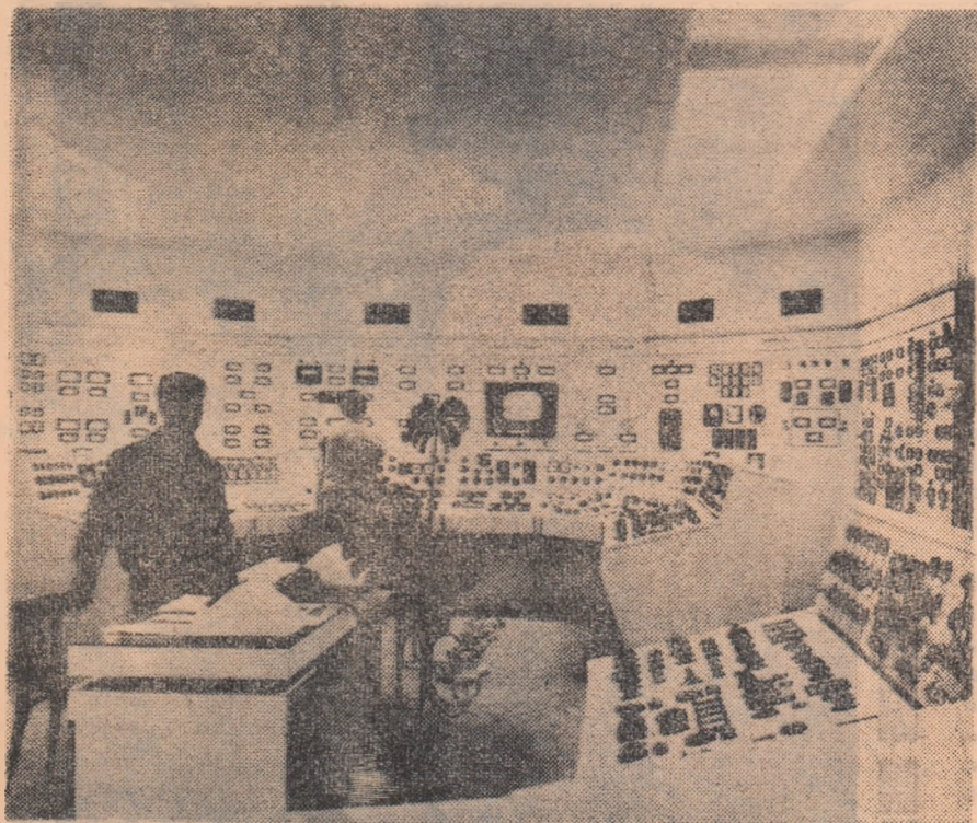
Camera de comandă a termocentralei Luduș Iernut.
