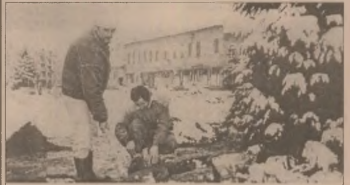
Deși este iarnă, Ion Cîmpean și Stan Rotaru de la Acvacalor Brad execută lucrări de reparații și întreținere
