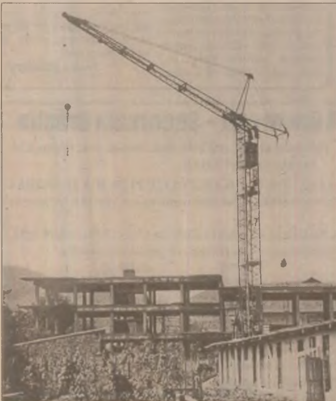
Și la Ilia, macaraua nouă turn stă nemișcată de ani și mai bine. Oare cât o sta așa?
