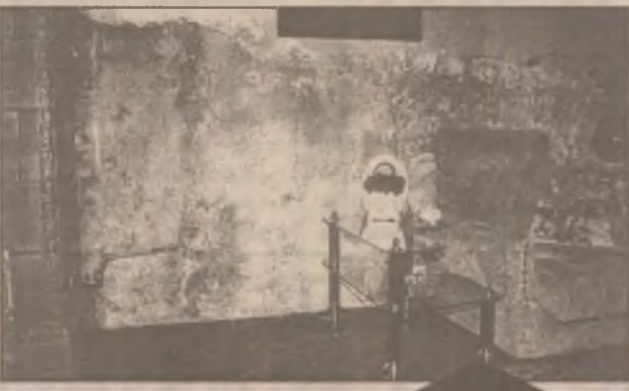
Aspect din interiorul unei încăperi a imobilului afectat.
