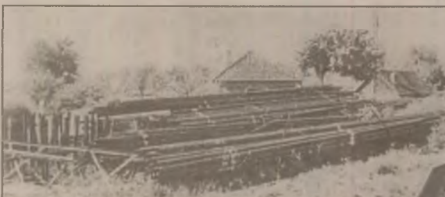
Pentru că nu are voie să execute lucrarea, societatea respectivă și-a abandonat materialele la marginea satului.
