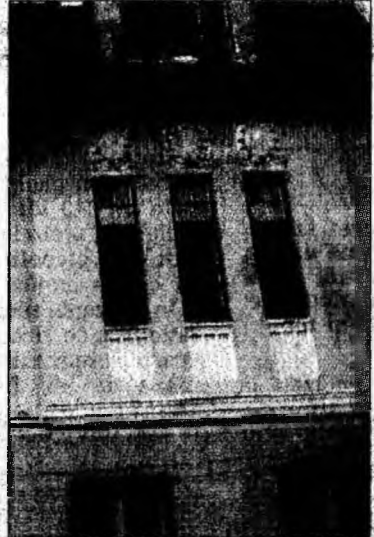
Clădire istorică în ruină.
