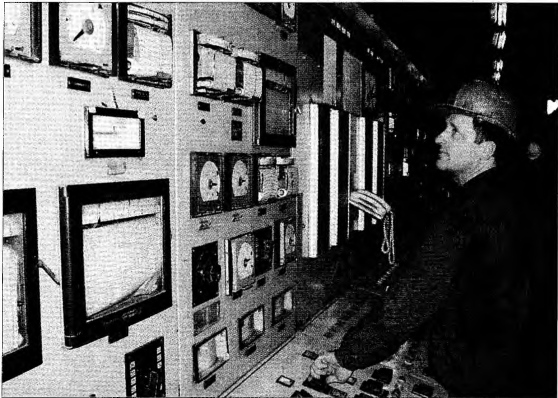
Termocentrala Mintia - Panoul de control
