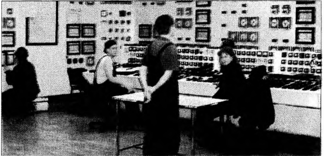
Sala de comandă de la Termocentrala Mintia
