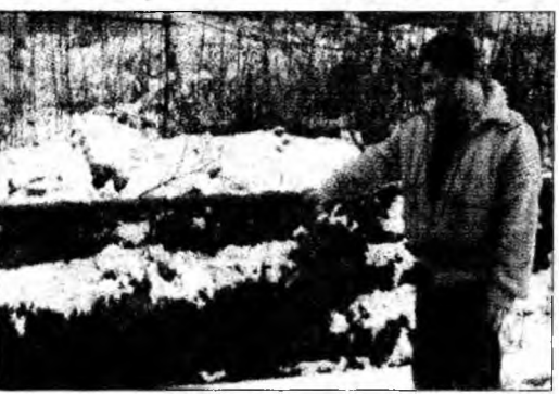
Peretele de beton al canalizării s-a desprins (Foto: T. Manu)
