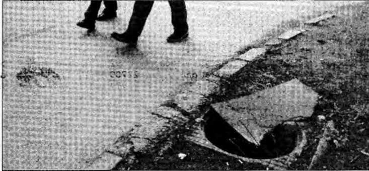
Unii cetățeni riscă să cadă în canalele fără capace
