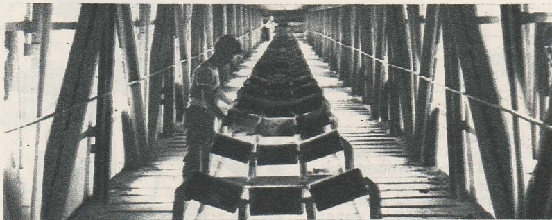
Un exemplu de folosire a tehnicii celei mai înaintate este această estacadă cu transportor de 84 metri.
