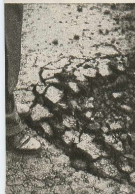
SA ARATĂ , după puțină vreme, o nouă șosea inaugurată recent în Anglia și care a costat imensă sumă de 10.000 lire! De-a lungul întregului parcurs șoseaua e plină de arămături, ridicături, crăpături etc. Bineînțeles că antreprenorii lucrării au ajuns la adevărata „succesă”, pentru că au câștigat pur și simplu, banii contabilului britanic. Ce ține de „libera întreprindere partitocratică”...
