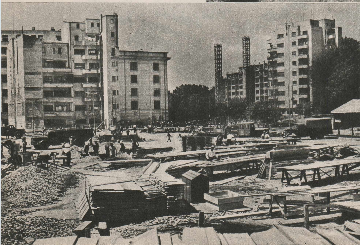
← O perspectivă a șantierului de construcții a blocurilor 6-9. Dulgherii și fierarii betoniști muncesc cu sîrg, asigurînd terminarea lucrărilor la termenul fixat.
