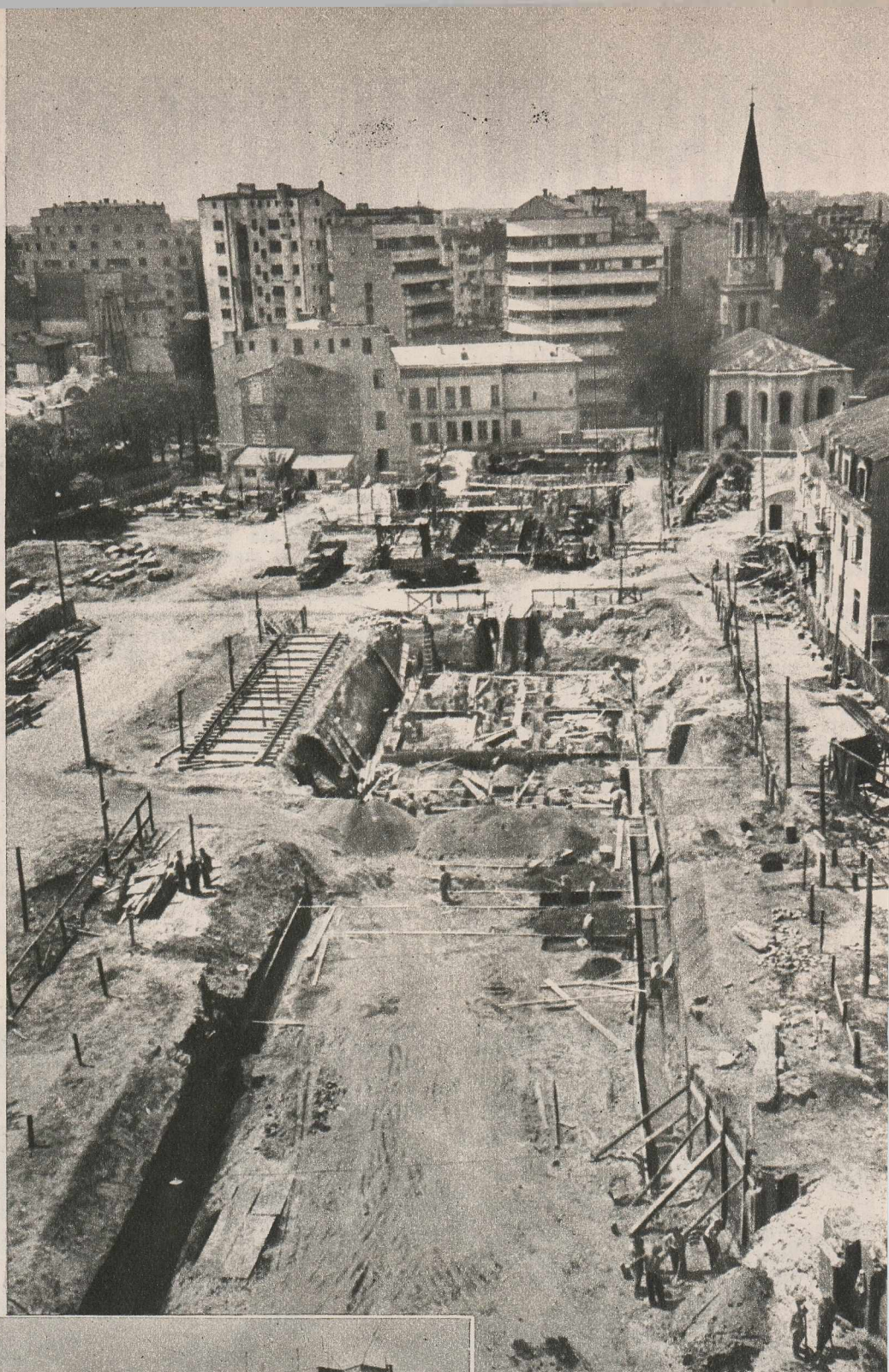
↑ Se toarnă fundațiile la blocurile 1 și 2, care încep din calea Victoriei (peste drum de Athenée Palace) și continuă până în str. Luterană.
