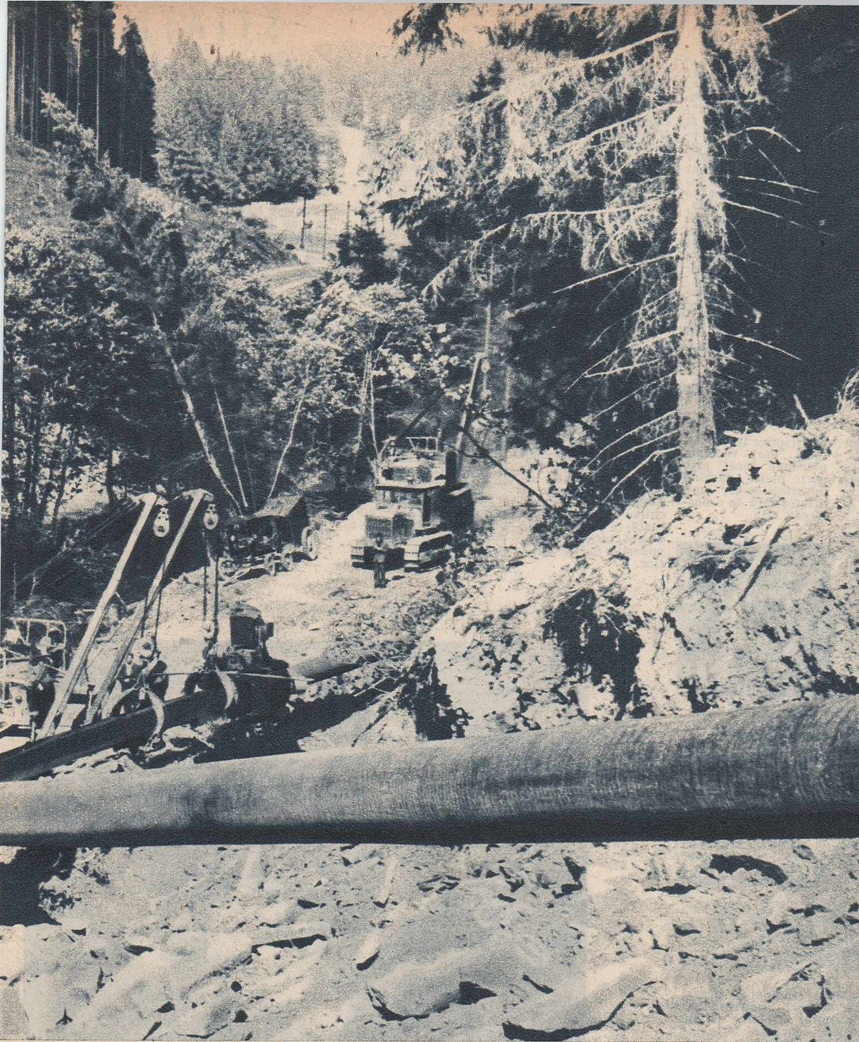
Pe traseul sovietic al șarpelui de metal au fost învinse cele mai multe obstacole naturale. Fotografia arată o secțiune a conductei ce trece prin Munții Carpați, spre Cehoslovacia. Muncitorii și tehnicienii sovietici au construit într-un ritm rapid conducta, care s-a unit cu secțiunea cehoslovacă în luna februarie.
