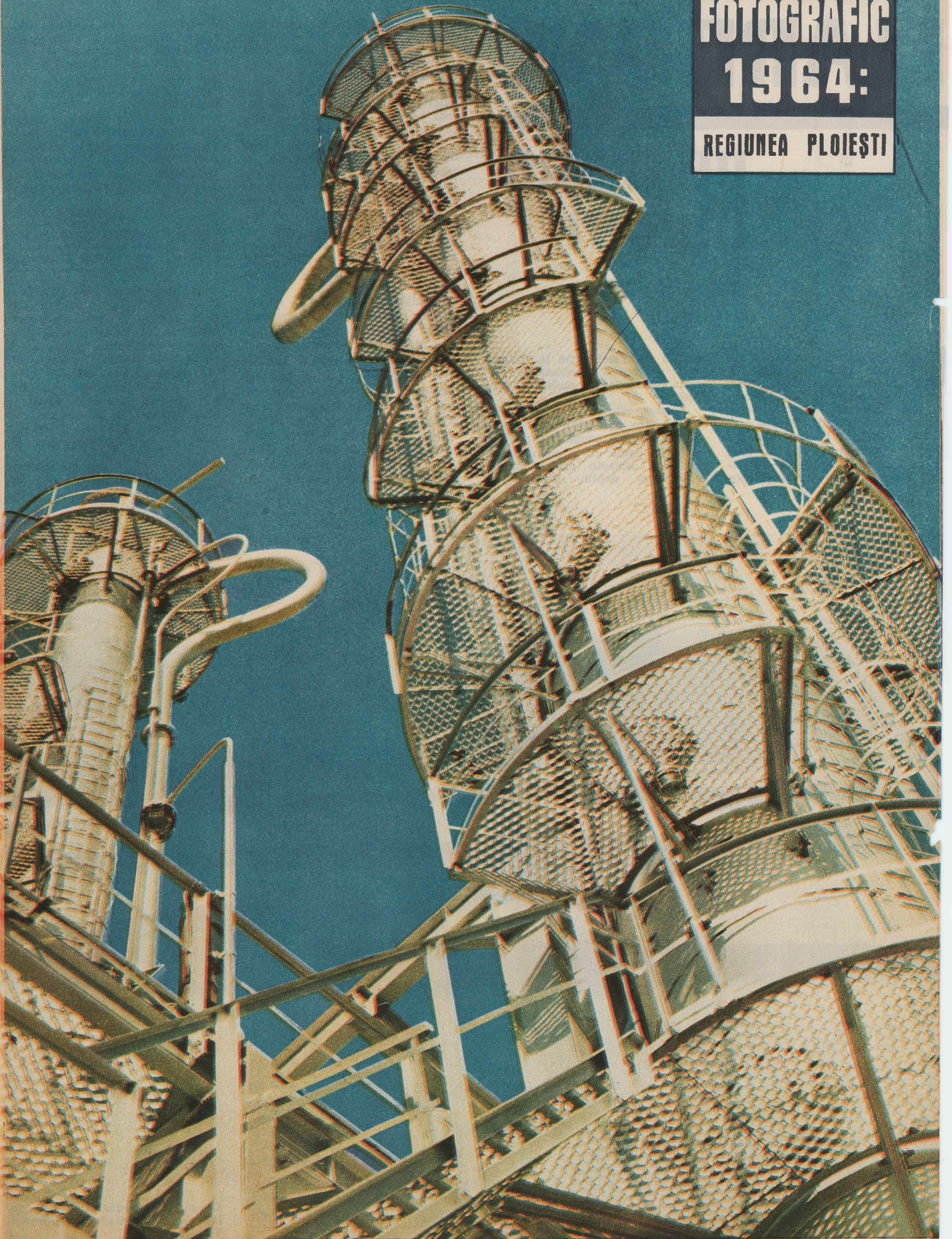
Rafinăria Ploiești-Nord. Instalația de rectificare a benzinei.
