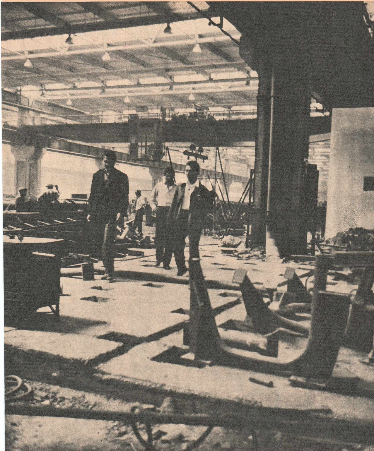
fundațiile terminate, constructorii uzinei de țevi «Republica» așteaptă de luni de zile un utilaj absolut indispensabil: utilaj auxiliar la mașini de rețezat cu disc abraziv, comandat la Uzinele mecanice-Aiud. Termenul de livrare: 31.1.1969.
