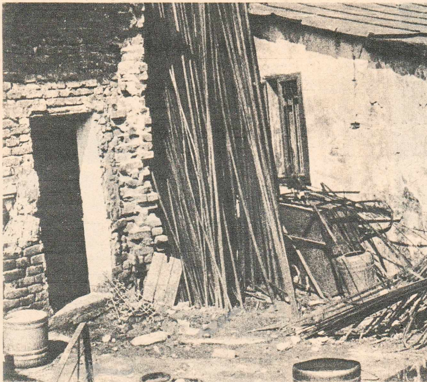
Depozitul de materiale al unității 46 din piața «Ilie Pintilie». Neorînduială în depozit, în atelier și în activitate.
