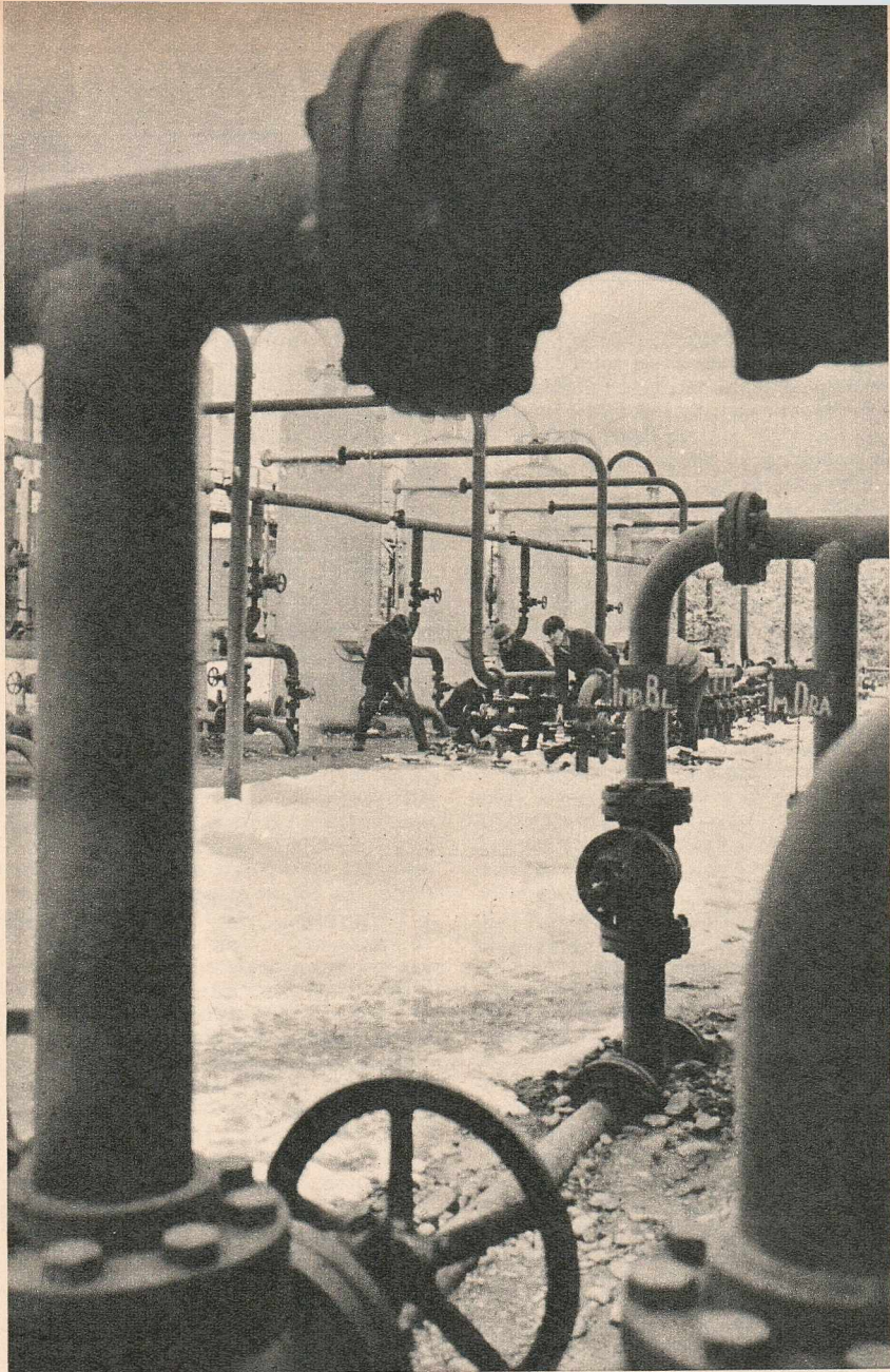
Presiunea separatorilor și rezervoarelor este menținută constantă spre a se asigura debitul de gaze prevăzută de caracteristicile tehnice ale instalațiilor...
