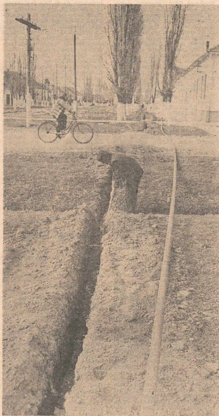
— La capătul acestei conducte se află două motoare pe gaz metan. Ele vor asigura independența energetică a Teremiei Mari.
