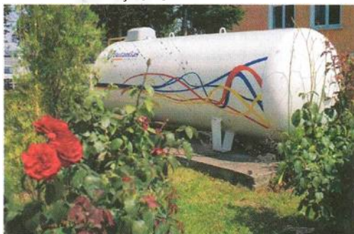
Canalul de distribuție propan
