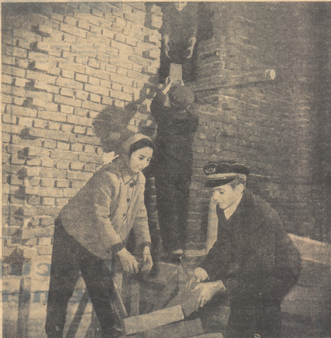
Brigada patriotică a elevilor de la școala de 7 ani Costeasca, din raionul Crivița Roșie și-a luat angajamentul de a contribui la terminarea în cel mai scurt timp a unei noi școli din raion. Iată cîțiva din membrii brigăzii lucrînd pe șantier.
