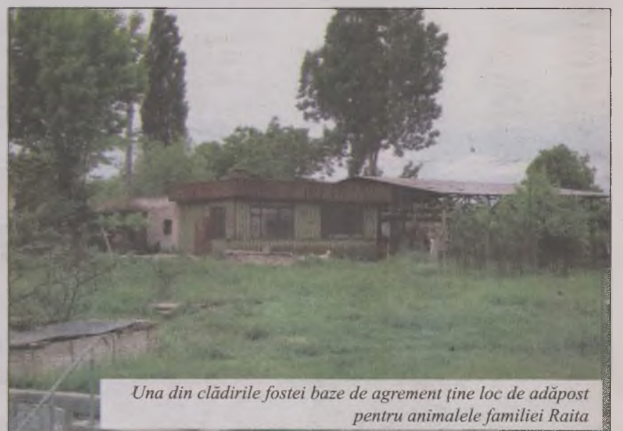
În ștrandul în care înainte de '89 se răcoreau hunedoreni, acum se mai scaldă doar broaștele
