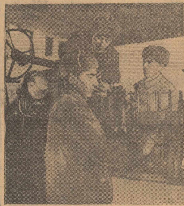
Mecanizatorii de la S.M.T. Călugăreni din regiunea București au reparat pînă în prezent 40 la sută din tractoare și 60 la sută din mașinile agricole. Ei s-au angajat să termine reparațiile cu 10 zile înainte de termenul stabilit. În cișeu: Brigadierul George N. Tudor împreună cu mecanizatorii Nicolae George și Ion Anton, în timpul asamblării unui motor de tractor.
