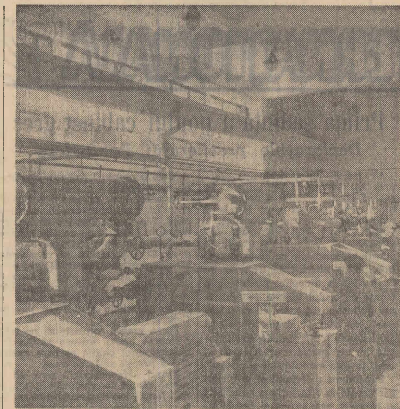
Combinatul chimic Victoria. Sala de compresoare a instalației de cracare a gazului metan.
