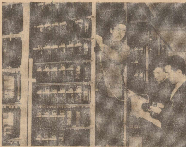
Sala de relea a stației C.F.R.-Ploiești-Sud, e în întregime automatizată. Tinerii ce se văd în fotografia noastră: Ion Ciocodan, Nicolae Buciu și Dumitru C. Dumitru, fac parte din echipa de întreținere și control periodic. Ei aduc o însemnată contribuție la buna funcționare a întregului complex de aparatură
