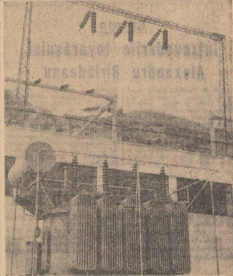
Transformatorul de 10 000 kVA, unul din produsele fabricate la uzinele „Rade Konciar”
