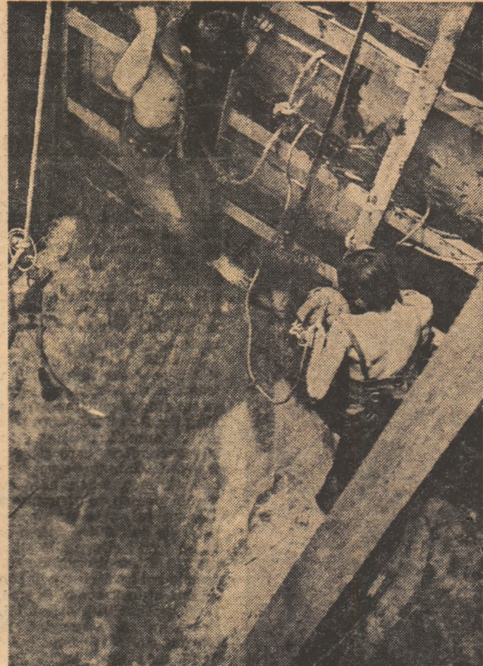
În orele critice, la porțile stăvilărilor Ciurei
