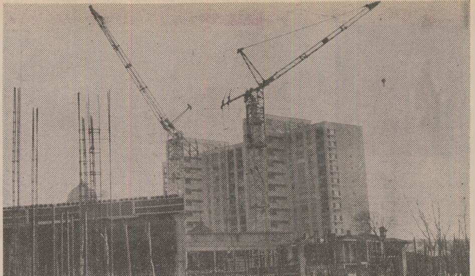
Imagini obișnuite oricărei localități, vorbind despre chipul nou al țării: geometria desenată de macaralele constructorilor...
