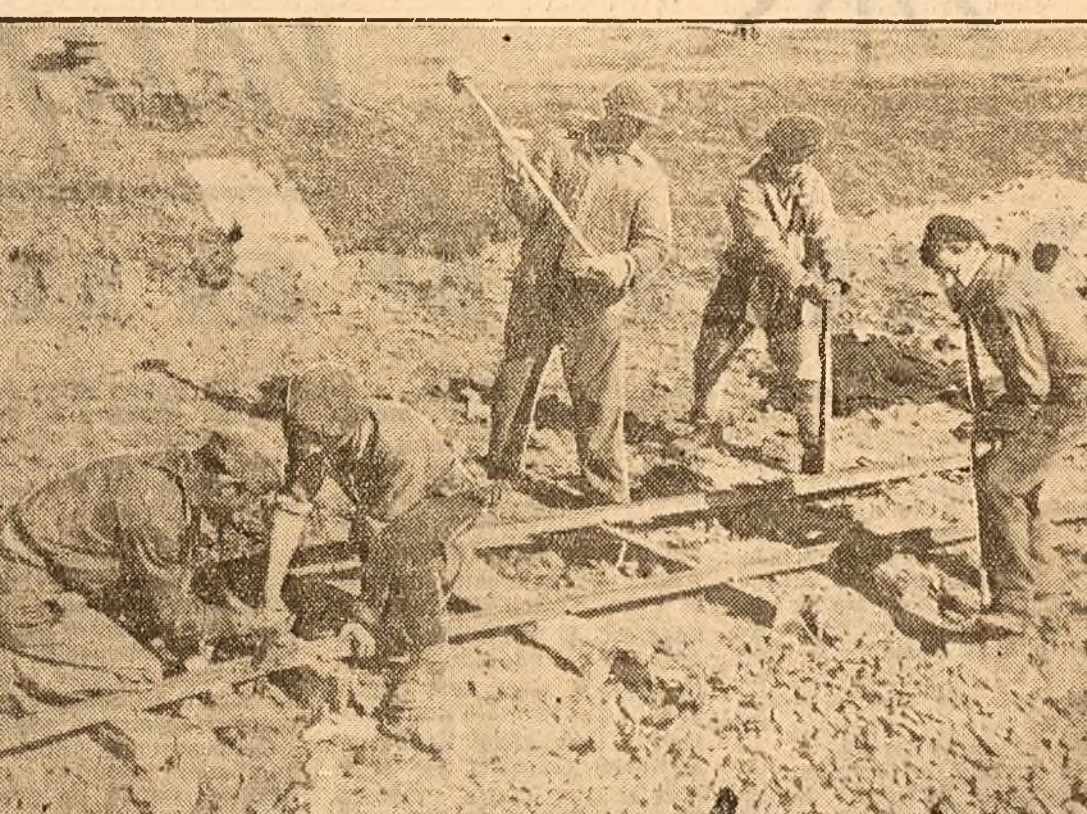
U.T.M.-iști din brigada „30 Decembrie”, prestează muncă voluntară la construirea unei linii de tramvai, care leagă cartierul muncitoresc Ronț cu Timișoara
