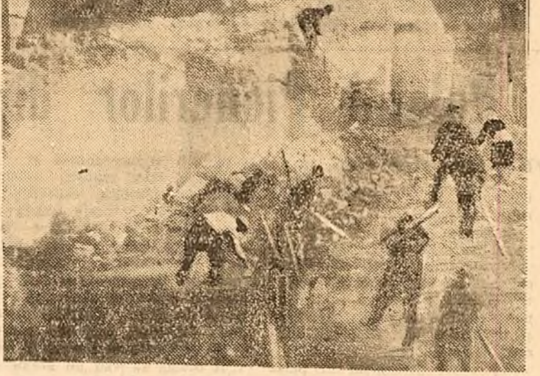
AL, ANCA Coresp. În locul acestei clădiri ruinate de bombardament, se va ridica în curând o școală primară. Cetățenii lucrează de zor la deblocarea dărâmaturilor. Ințelul cu înțelul, orașul Dej va căpăta o altă față.
