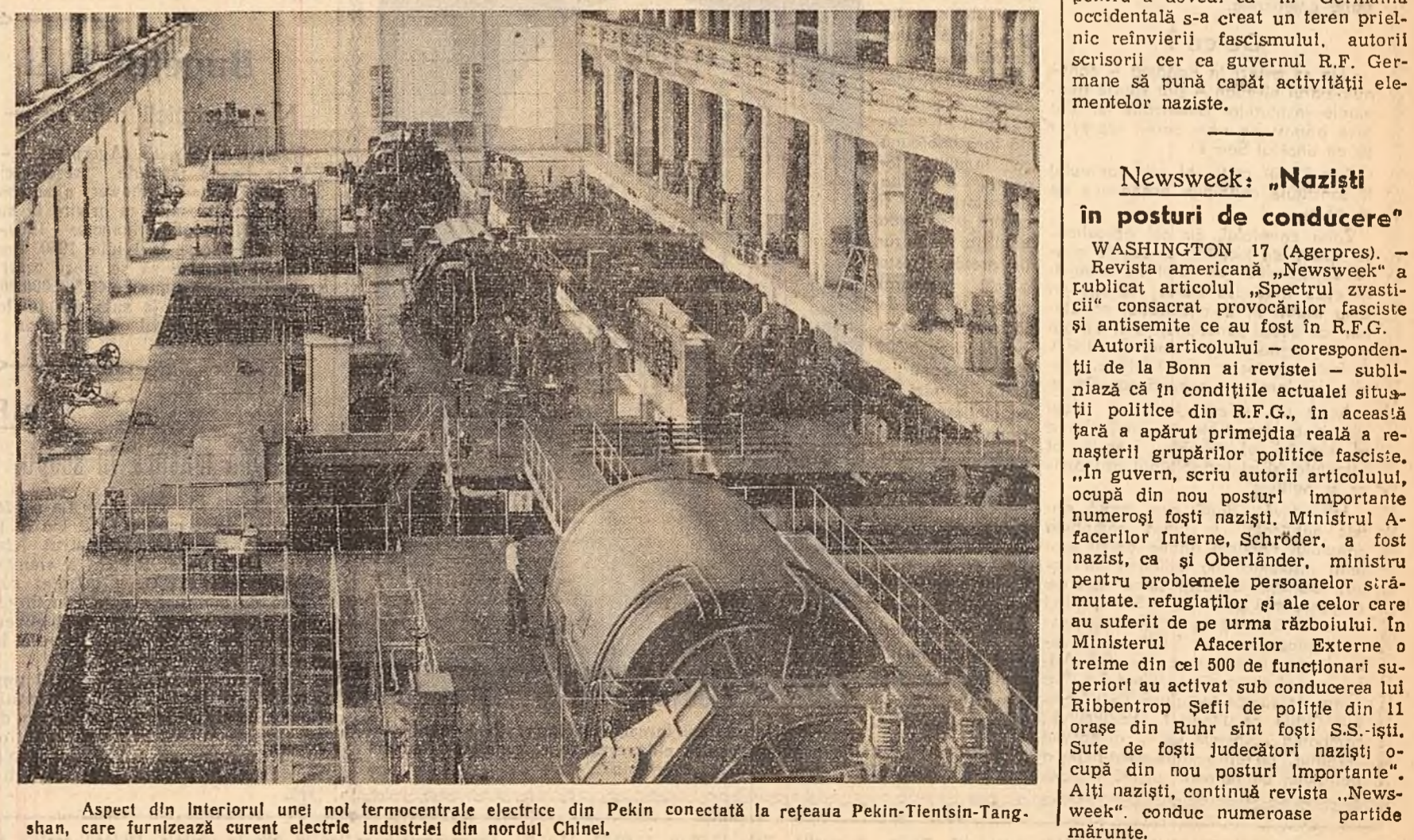
Aspect din interiorul unei noi termocentrale electrice din Pekin conectată la rețeaua Pekin-Tientsin-Tang-shan, care furnizează curent electric industriei din nordul Chinei.
