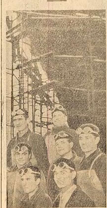
Brigada de sudori condusă de Petru Roman de la Șantierul Naval de Galați — frunțasă pe întrecerea în lupta pentru o productivitate ridicată.
