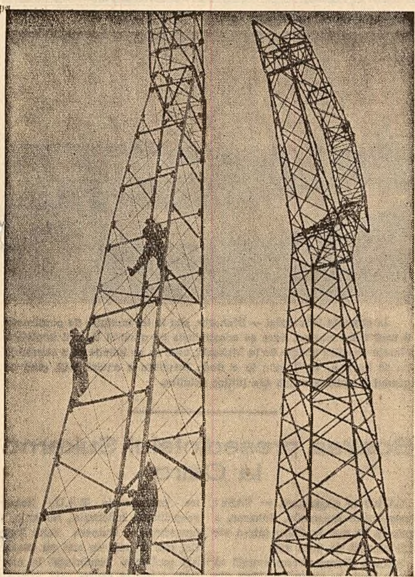
Întreprinderea nr. 7 de construcții metalice și prefabricate — unitatea Oopeni. Se montează stâlpii de înaltă tensiune înainte de expedierea lor.
