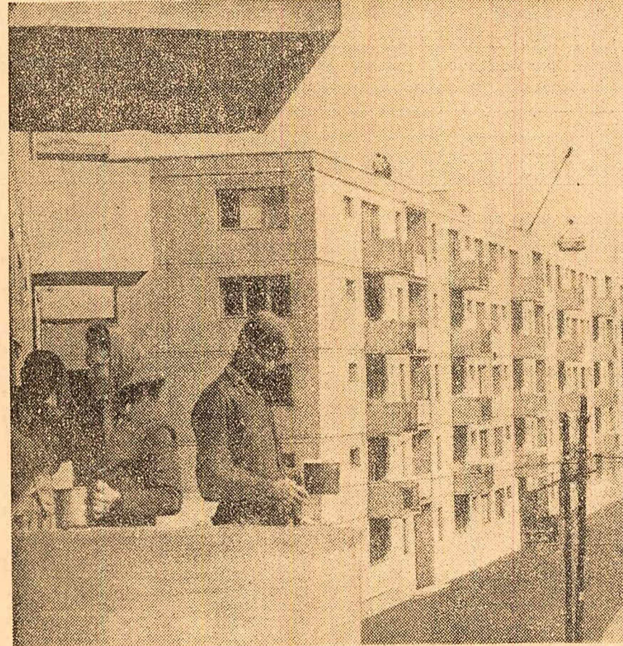
Constructorii din Reșița execută finisajele exterioare la un nou grup de blocuri
