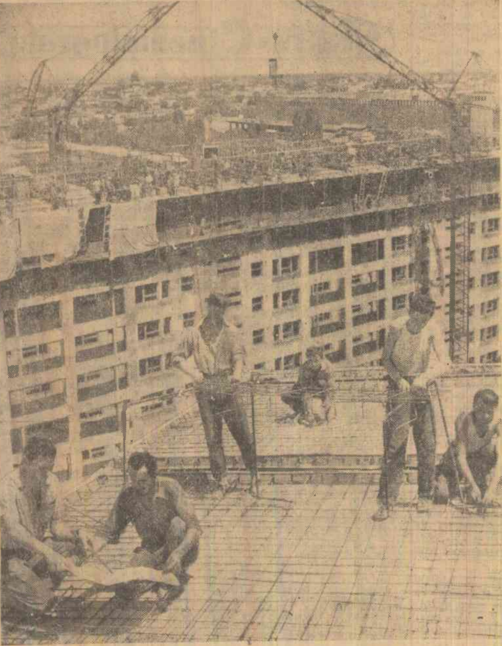
Pe șantierul Mihai Bravu-Christigiu din Capitală, Blocul P4, care se construiește cu ajutorul cofrajelor gisante, se află într-un stadiu avansat față de grafic.
