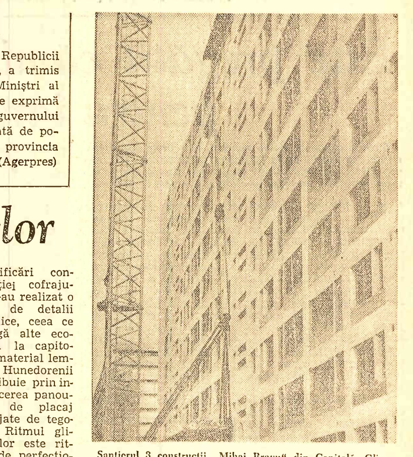
Santierul 3 construcției „Mihai Bravu” din Capitală. Glisarea blocului O-1, cu 132 apartamente, pe care-l vedeți în fotografie, a început la 4 septembrie și s-a terminat la 17 septembrie. O dovadă a ritmului rapid în care se construiește cu ajutorul acestei metode. (Foto: M. ANDRESCU)
