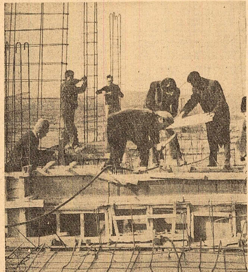
Șantierul Ploiești Nord. Echipa de fierari-betonisti condusă de Costin Ștefan montează la etajul 9 al blocului nr. 15 armăturile metalice Foto: M. Cloș
