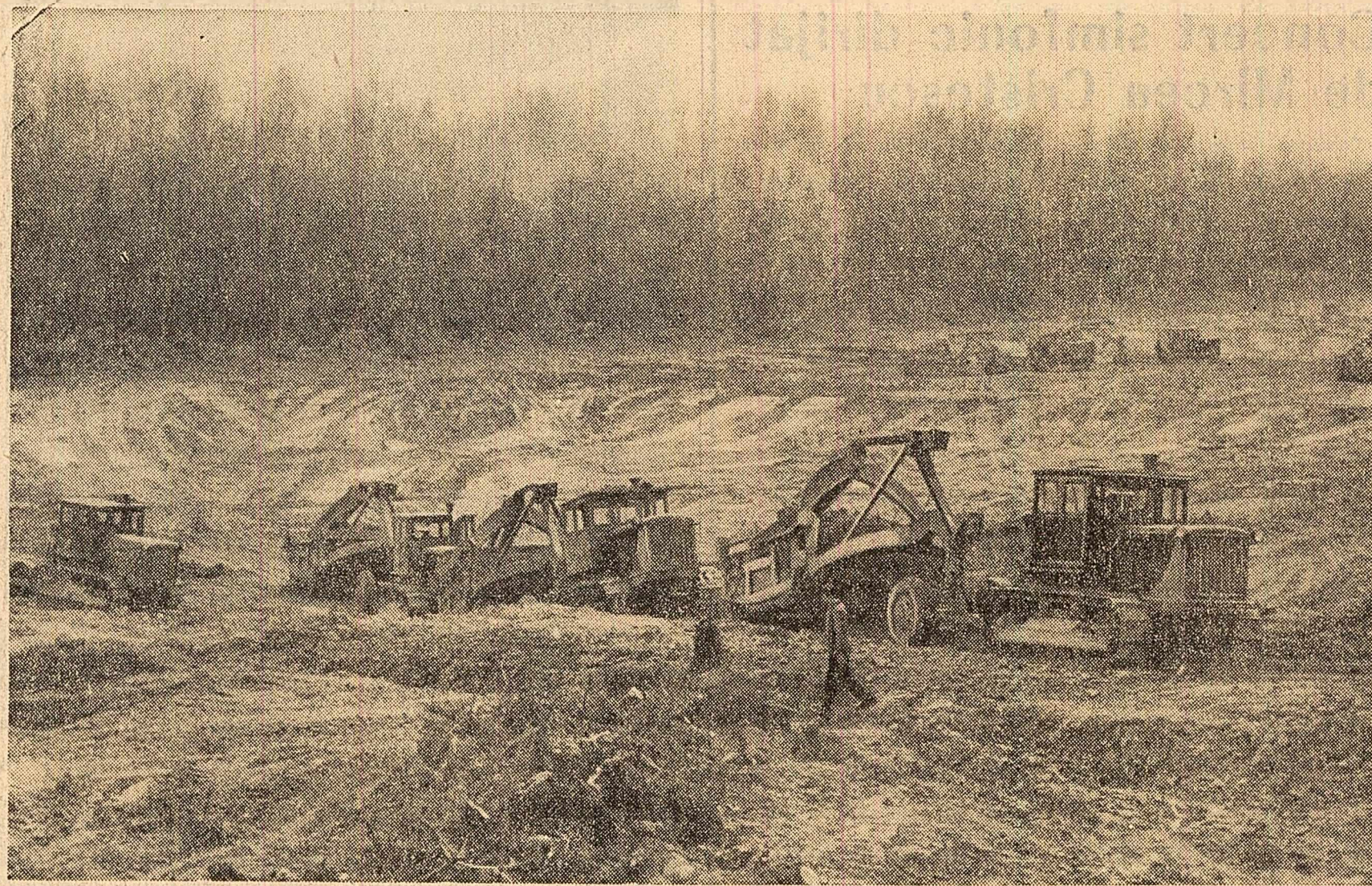
În luca inundabilă a Dunării continuă cu intensitate lucrările de punere în valoare a unor noi suprafețe de teren prin îndiguliri, desecări și defrișări. În fotografie: pe șantierul de la Mahtru Foto: A. Cartoian
