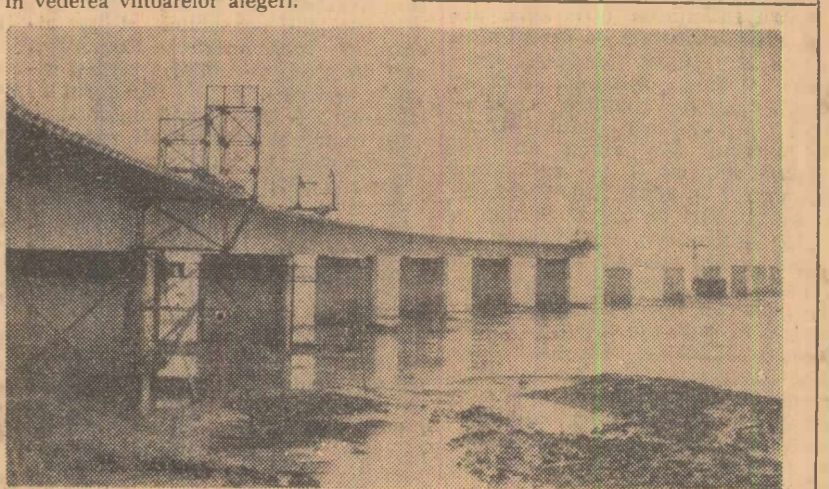
Între insula Oleron din Golful Biscaya și țărmul Franței, se află în construcție un pod care va avea o lungime de 3076 metri fiind considerat cel mai lung pod din Europa
