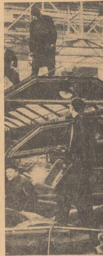
În secția de montaj prin sudură a Uzinei de vagoane din Arad
