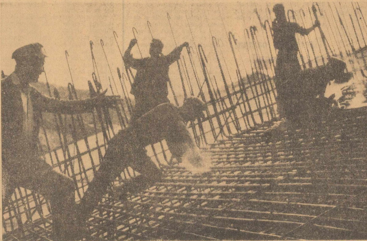
Brigada de fierari betoniști condusă de Ion Bădiță pe șantiierul hidrocentralei Bacău II
