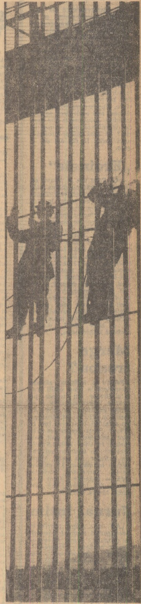
Secvență de pe șantierele Sistemului hidroenergetic și de navigație Porțile de Fier
