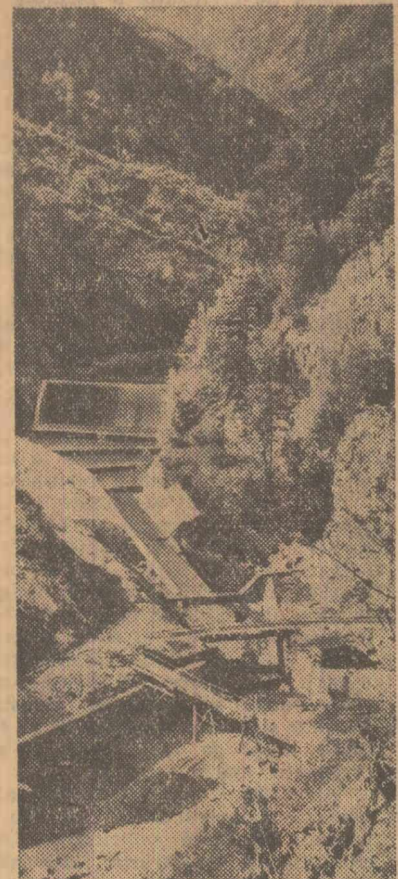
Vedere de pe șantierul barajului Pal-tinul, necesar alimentării cu apă a zonei industriale Ploiești
