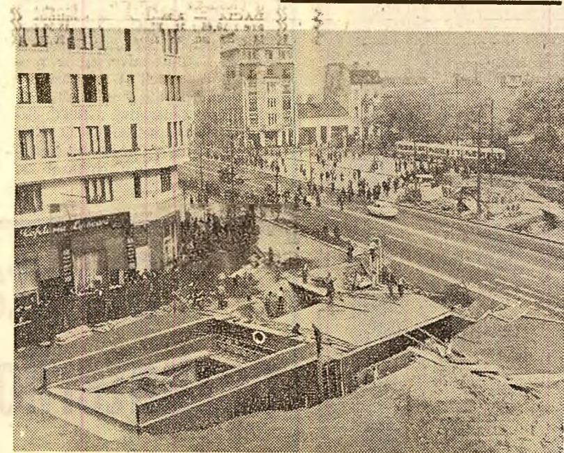
Șanțierul pasajului subteran pentru pietoni din Piața Sf. Gheorghe din Capitală. Foto: M. Cio
